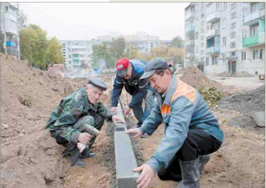
КУП «Гроднааблдарбуд» актыўна ўдзельнічае ў абнаўленні і рэканструкцыі дваровых тэрыторый жылёй забудовы ў абласным цэнтры. Работчы Ваўкавыска, Карэліч, МЯЛІНОУСКІ, Іван АПАЛОНОВІЧ і Віктар МАЯГАЧАУ.
