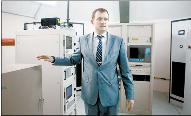
Ва ўсіх тэхнічных памяшканнях наземнага комплексу кіравання працуюць сістэмы фільтравання паветра, вентыляцыі, падтрыманніа мікраклімату і пажаратушэння.
