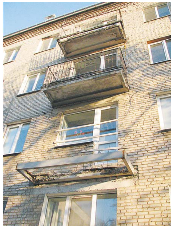
Падобны металічны каркас на месцы былога балкона ўжо правяраны на трываласць. Атрыманыя вынікі накіраваны на зацвярджэнне экспертызы.
