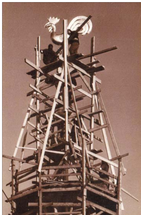
Другі Домскі пеўнік. На фота зафіксаваны працэс дэмантажу будаўнічых лясцоў у 1985 годзе.
