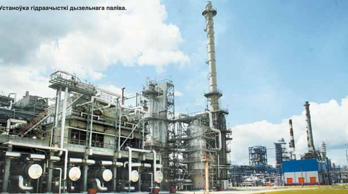
Устаноўка гідрачысці дызельнага паліва.
